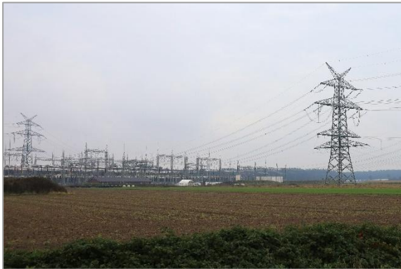
Abb. 5-8: Energieinfrastruktur östlich des Plangebietes (09/2025)
